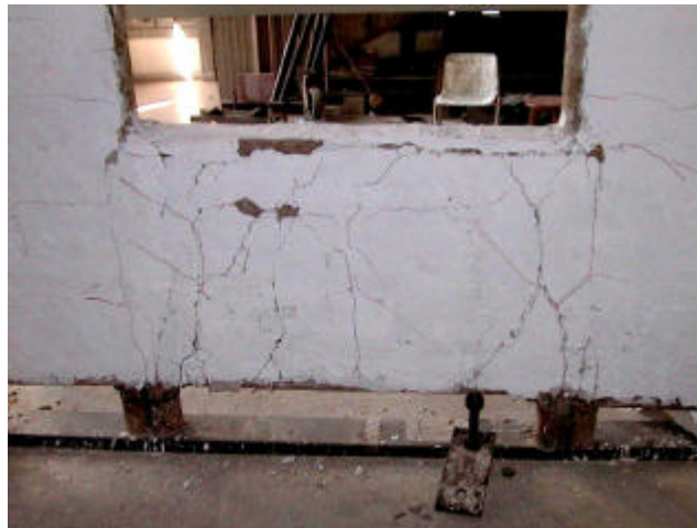
Foto 5. Grietas en revoque
