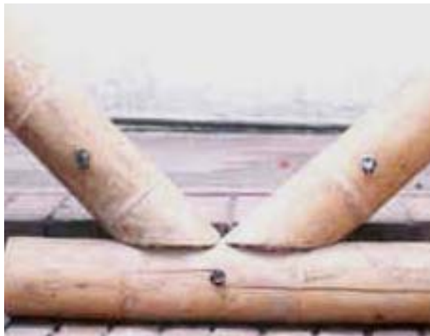
FOTO 35 FALLA UNION DG 45°
