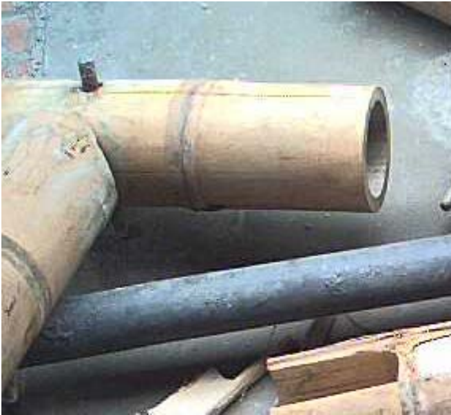
FOTO 43 FALLA UNION DG 90° TENSION
