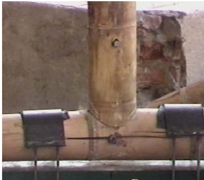
FOTO 30 FALLA UNION DG 90° TENSION
