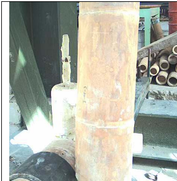
FOTO 27 FALLA SVM 90° POR LONGITUD DE DESARROLLO
