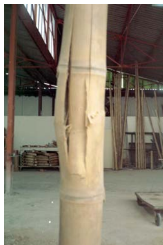
Foto No. 41. Falla por aplastamiento
