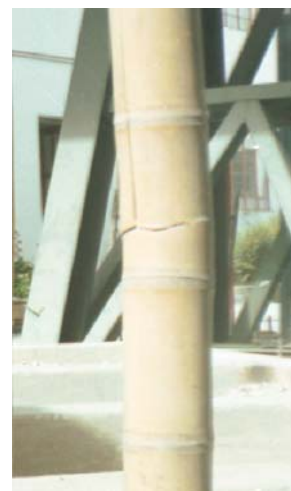
Foto No. 42. Falla por pandeo.
